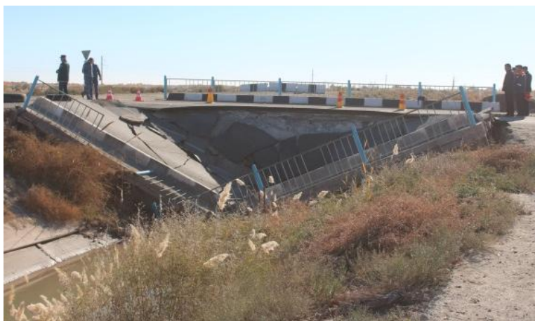
Фото1. Разрушения моста в Хорезмской области
